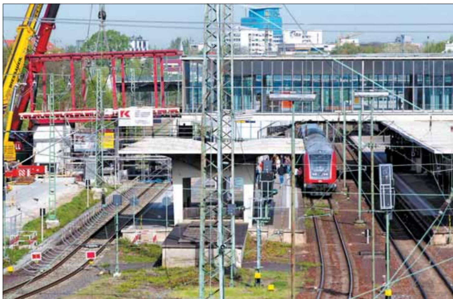
Zwischen neun und elf Uhr wurden am Montagmorgen 106 Tonnen Stahl in Position gehievt. Die Brücke über die Bahngleise soll in die zukünftige Bahnstadt verlängert werden. Foto: Hoppe
